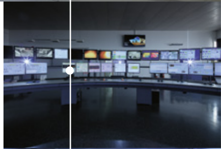
Poste de contrôle central
